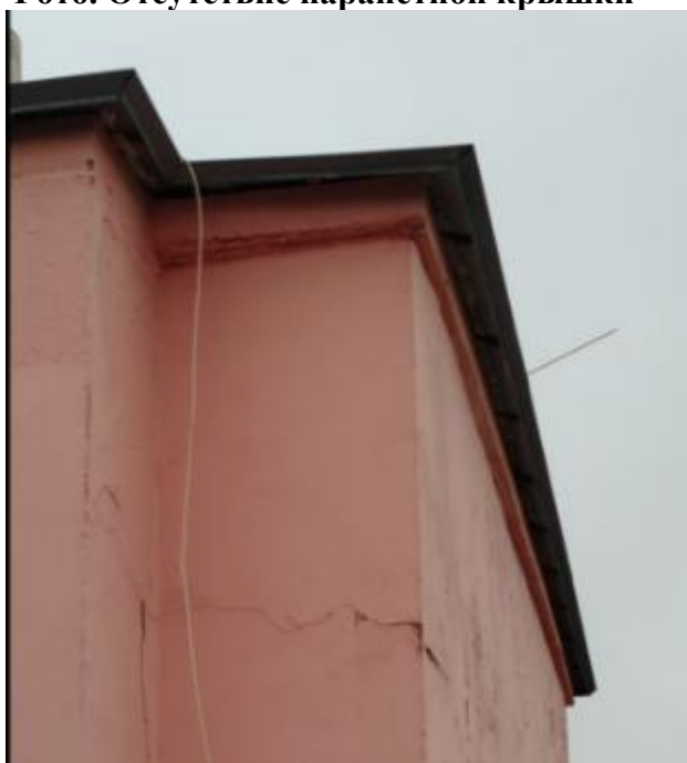
Фото. Раскрытие трещин
