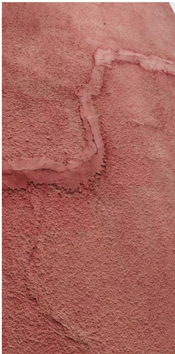
Фото. Некачественный ремонт
