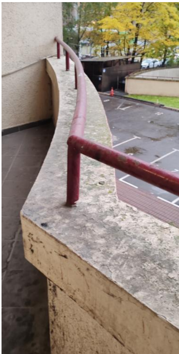
Фото. Отсутствие парапетной крышки
