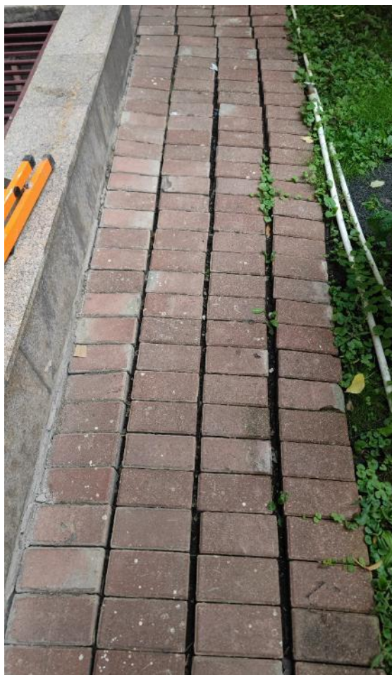
Фото 12 Нарушение целостности отмостки
