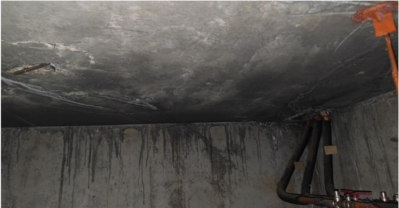
Фото 11 Следы замачивания стен
