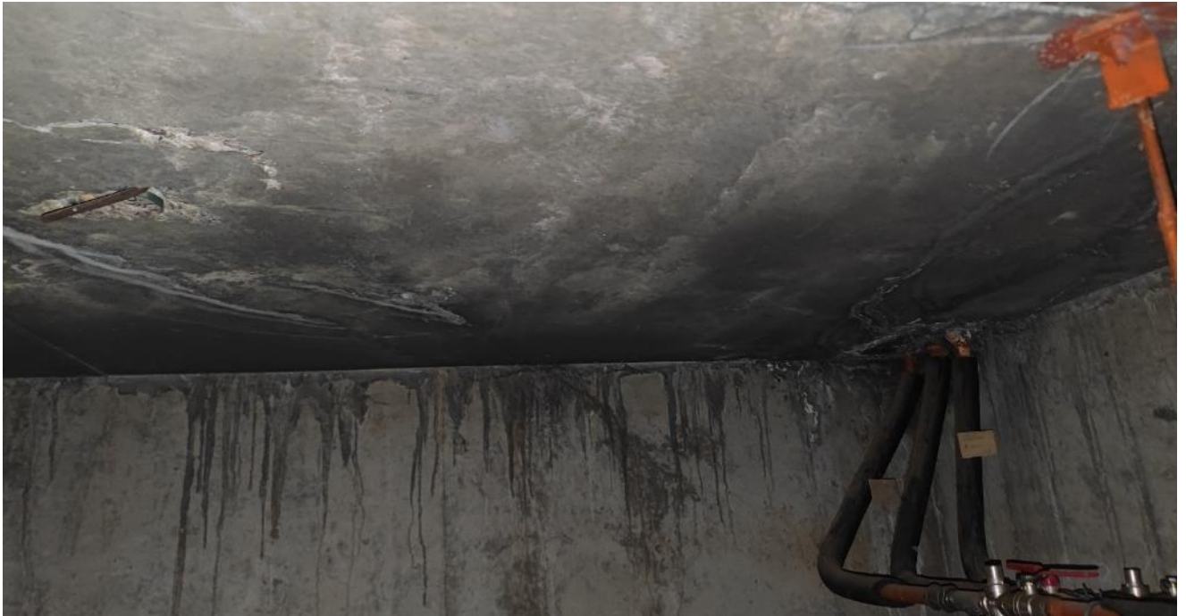
Фото 11 Следы замачивания стен
