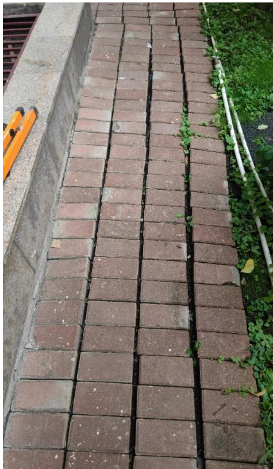
Фото 12 Нарушение целостности отмостки
